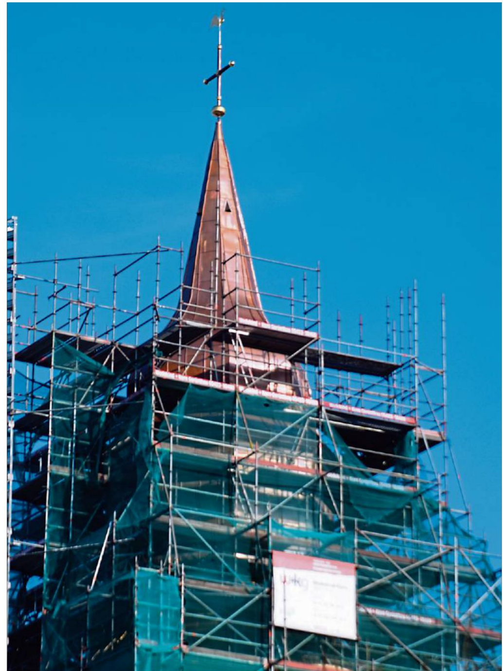
Die Sanierung der St.-Matthäus-Kirche ist offiziell abgeschlossen. Derzeit wird das Gerüst abgebaut. Der neue Kupferturm ist bereits freigelegt.
