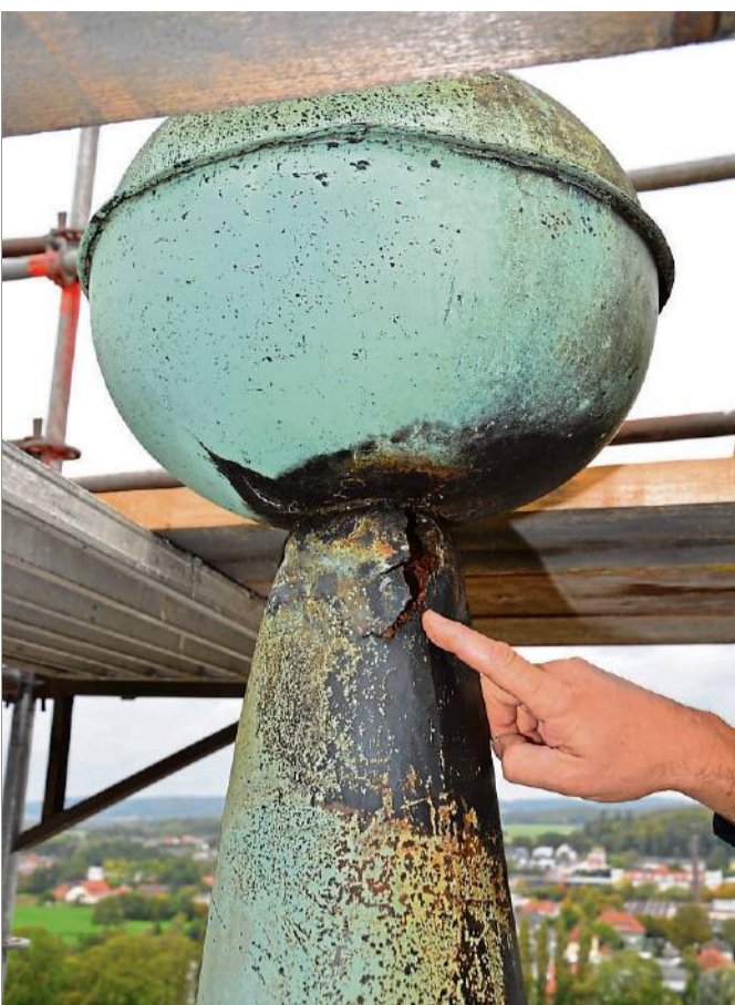
Risse haben sich an der Außenverkleidung des Turmkreuzes gebildet.
