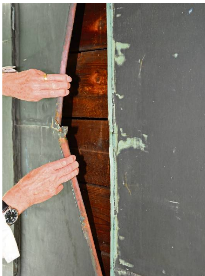
Nicht mehr miteinander verbunden: die Kupferbleche an den Seitenteilen der Turmhaube.
