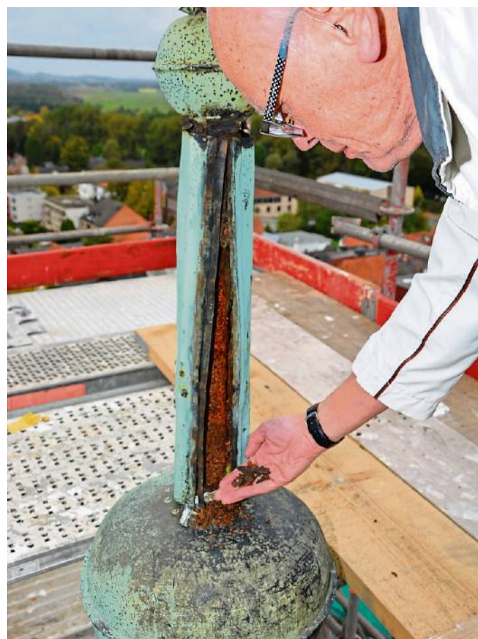
Da brösel der Rost, und die Kupferabdeckung spannt sich auseinander.
